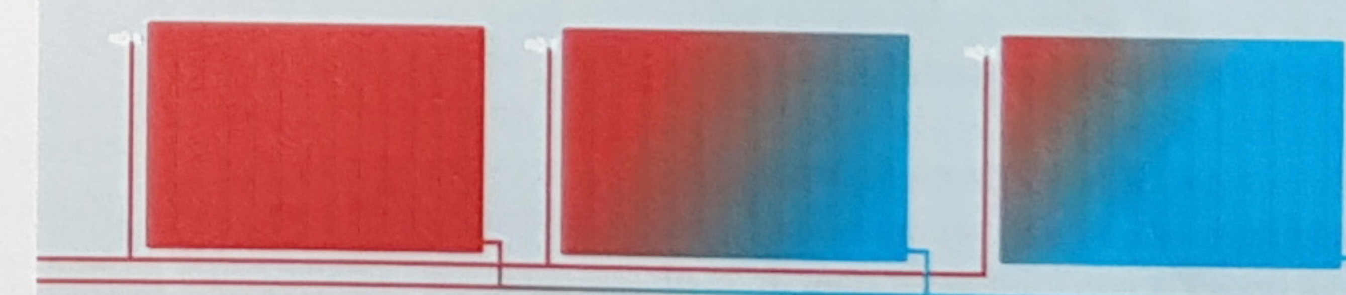
Niet goed ingeregelde radiatoren
